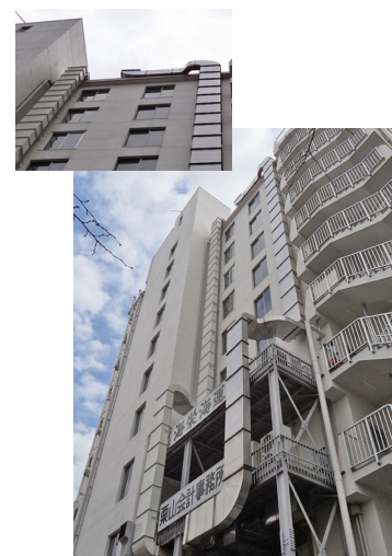
近隣への臭気や煙対策として屋上から排気している例
